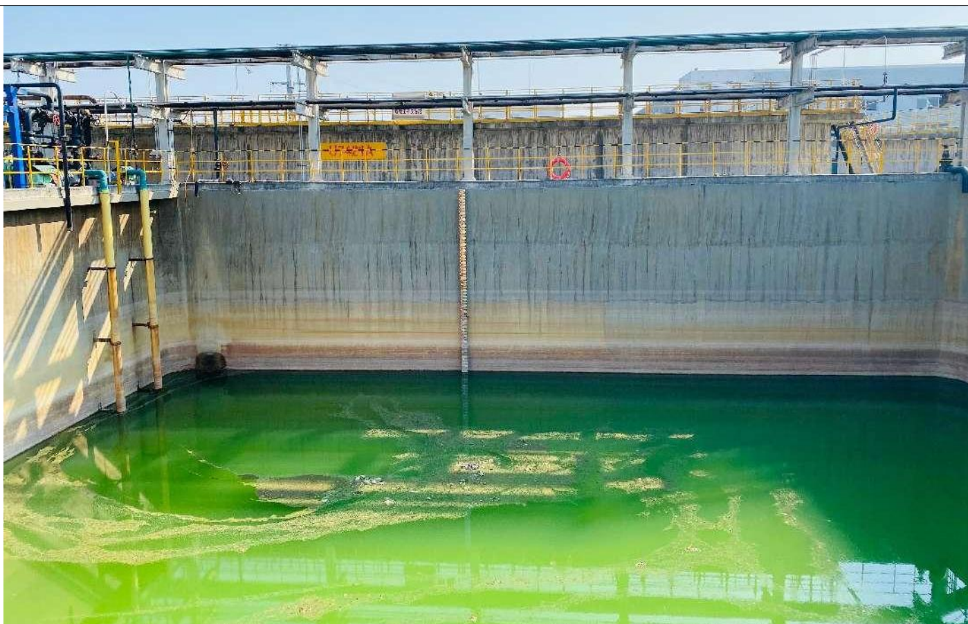
二期 4000m 3 事故应急池（兼初期雨水池）
