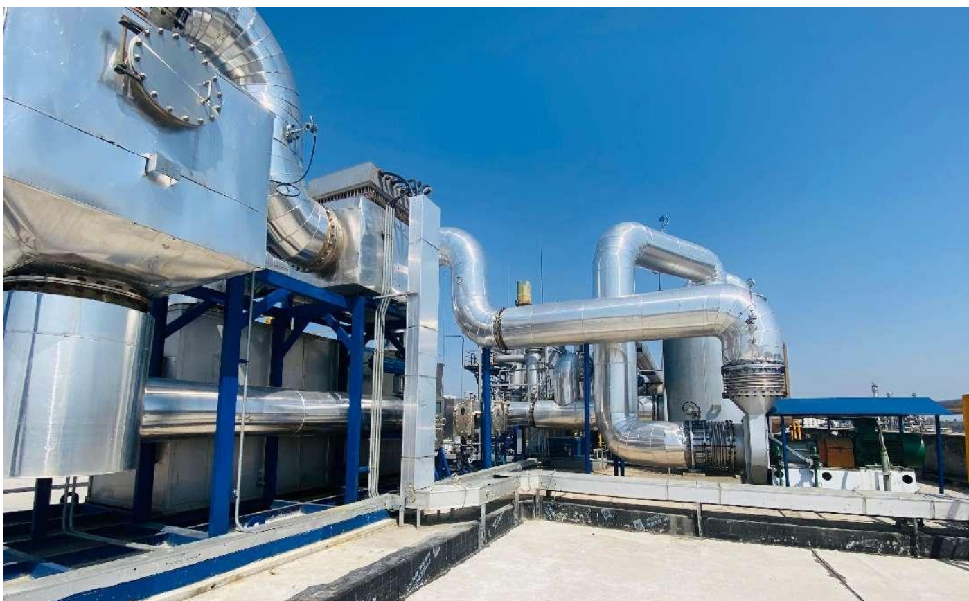
DA041 云溪钛硅焙烧废气排放口
