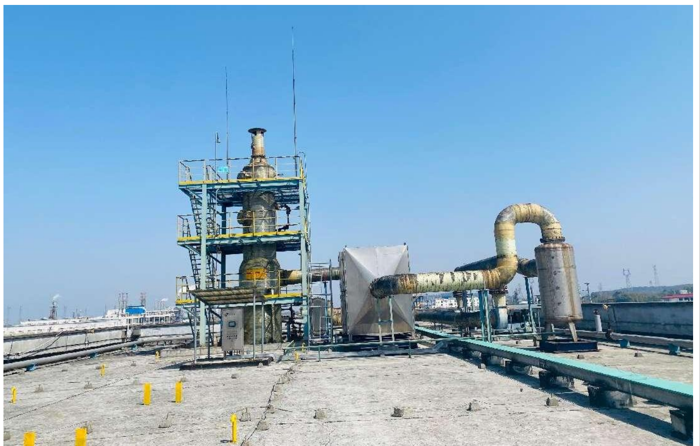
DA040 云溪钛硅改性废气排放口
