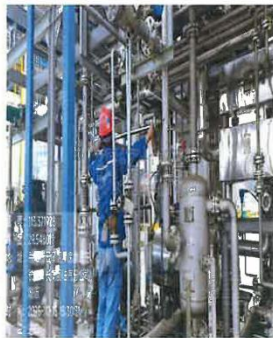
DA001 排气筒进口废气处理设施前采样孔 (10.15)
